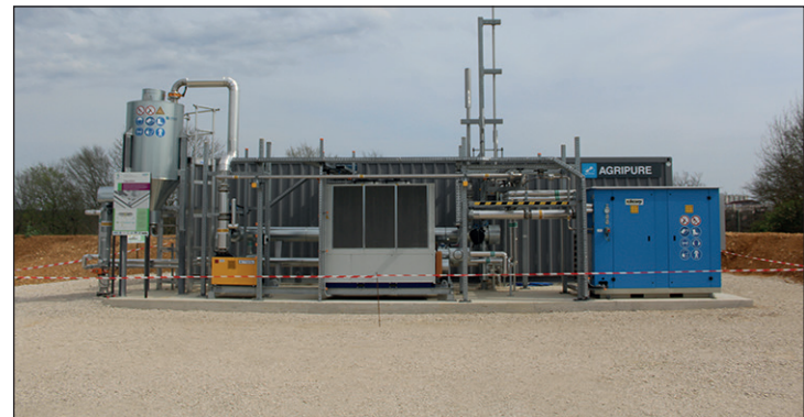
Système de purification du biométhane.
